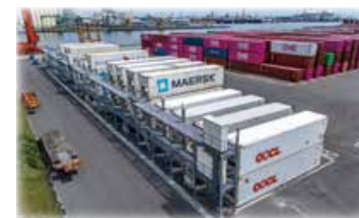
冷凍電源設備 温度管理が必要な農林水産物等の貨物も多く扱うことができます。(2024年7月完成)
